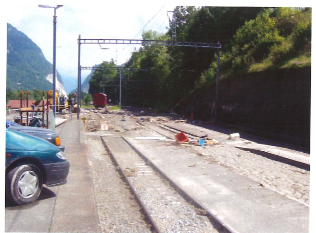
Was vom Bahngleis-Bach übrigblieb...
