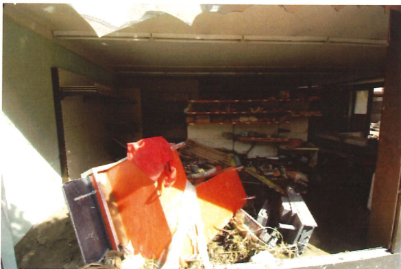
Blick in den völlig demolierten Verkaufsraum des Denner-Satellits in Oey.
