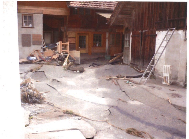
Sogar den Teerbelag hat das Wasser unterspült.
