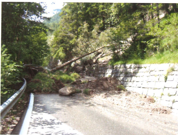
Grosse Mengen an Gestein und Bäumen wurden dort auf die Strasse verfrachtet, wo diese nicht weggeschwemmt wurde.
