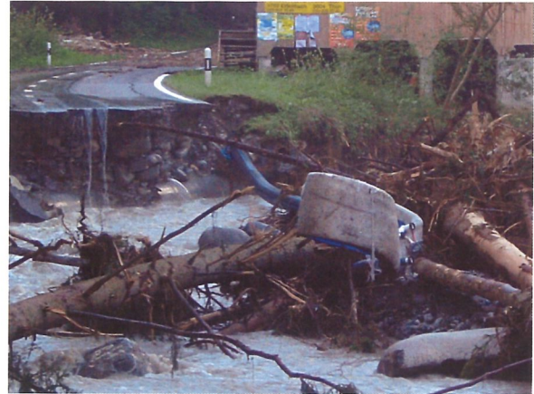
Weggespülte Strasse und herausgerissene Leitungen in der Nähe von Horboden.
