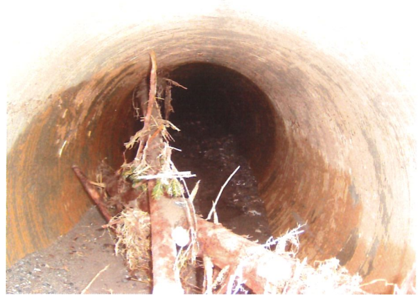
Viele Abwasserschächte sind völlig verstopft. Hier ein Beispiel mit Holz und Schutt.
