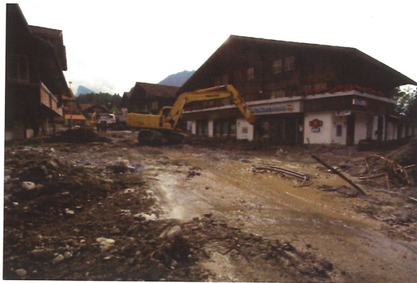
Schlimmes Bild vom Raiffeisenbankgebäude. Auch die Dorfstrasse weist hier grosse Schäden auf (26. August)
