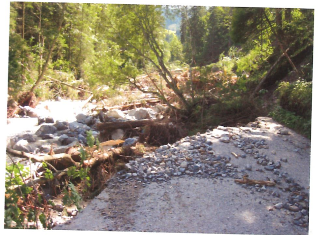
Schlimmes Bild am oberen Chirel. Hier wurden alle erneuerten Brücken weggerissen.
