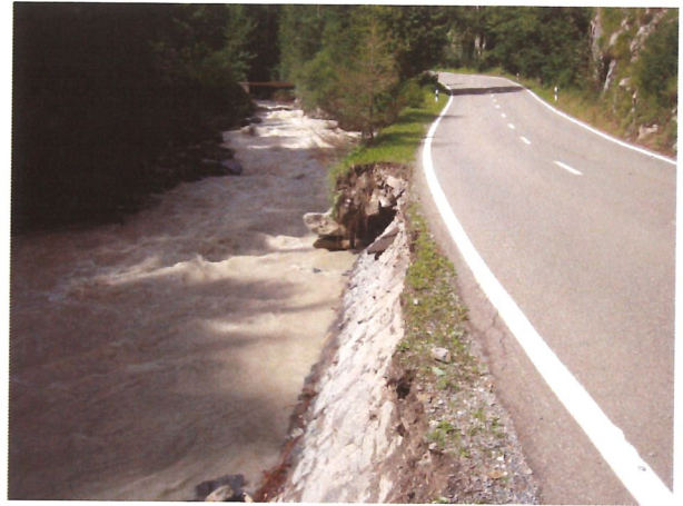
Gefährliche Unterspülung der Fahrbahn.
