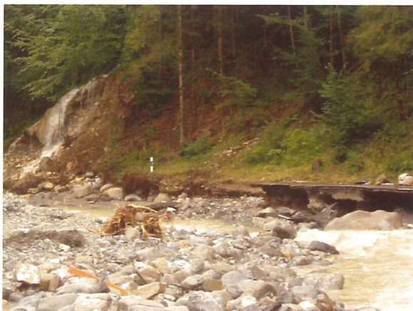
Vielorts wurde die Strasse weggeschwemmt. Man kann ihren Verlauf nur noch erahnen.
