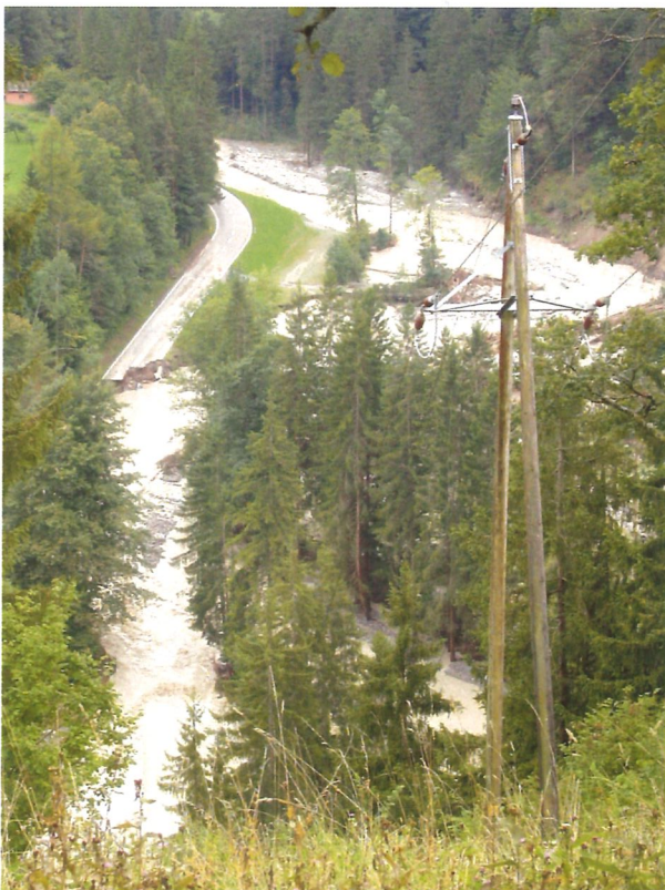
Auch dieser Abschnitt der Strasse ist zerstört.
