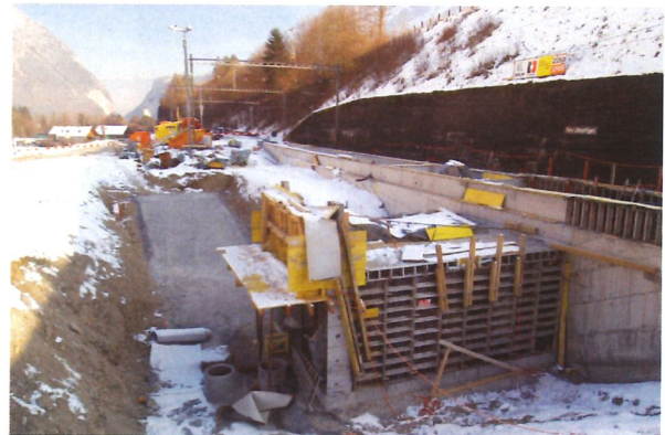
Im Zuge der Erneuerungen erhielt der Bahnhof Oey eine Personenunterführung. Hier ein Bild vom Rohbau, aufgenommen im Dezember 05.
