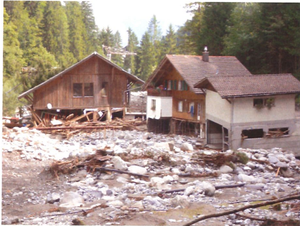
Deutlich sichtbar ist die Unterspülung dieser Häuser im Horboden.
