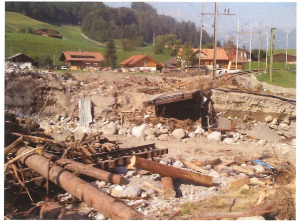
Der neue Chirellauf hat die Geleise unterspült.
