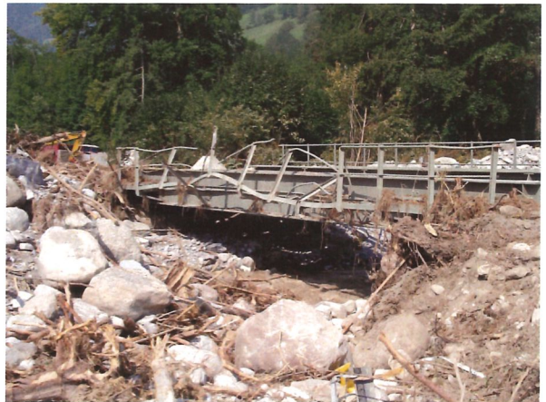
Das war die Eisenbahnbrücke. Bis Ende Oktober 2005 fährt hier kein Zug mehr.
