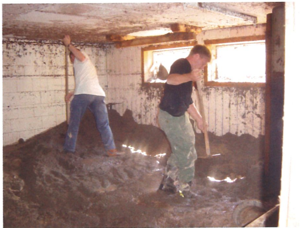
Bis zur Decke wurde dieser Keller mit Schlamm gefüllt. Er muss in mühsamer Handarbeit ausgeschaufelt und gepumpt werden.
