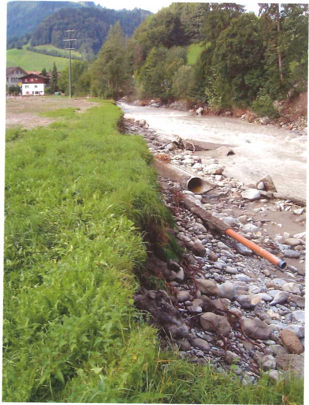
Auch hier ein deutliches Bild der Zerstörung. Vielerorts wurden Leitungen einfach weggespült.
