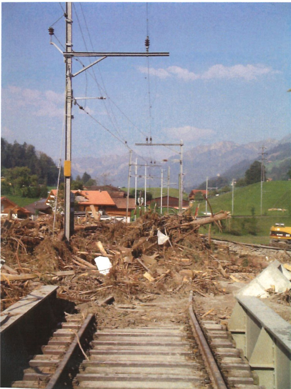
Kaum zu glauben, dass hier einmal ein Bahngleise war. Blick von der Chirel-Bahnbrücke in Richtung Simmental.
