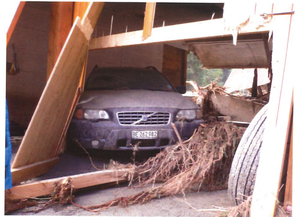
Eingeklemmt zwischen Teilen der Garage steht das Auto immer noch da.
