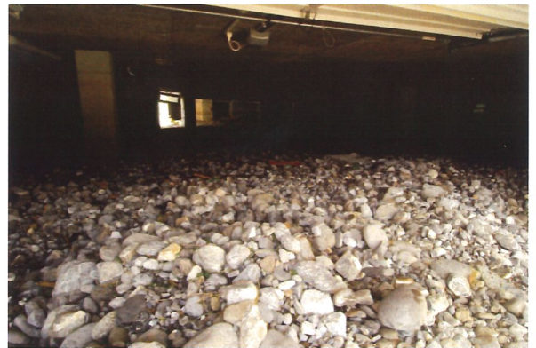
Diese Tiefgarage haben wir schon weiter vorne vorgestellt. So sah sie nach Abfluss des Wassers aus.
