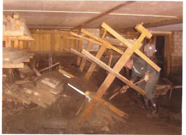
Auch hier muss alles rausgerissen werden.
