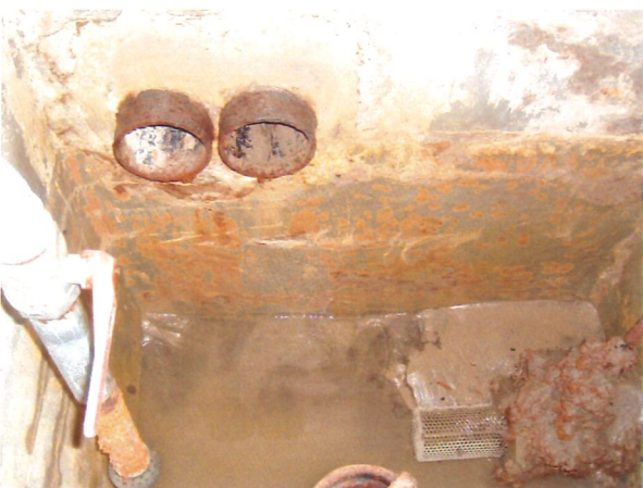
Diese Brunnstube der Wasserversorgung sieht traurig aus.
